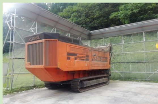
一軸破碎機(ドップシュタット)と、新たに設置した、廃棄物の飛散防止用のネット
